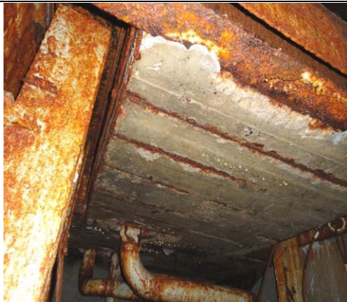
Attēls Nr.1 Tehniskā ūdens krasta akas centrālās kameras pārsegums
