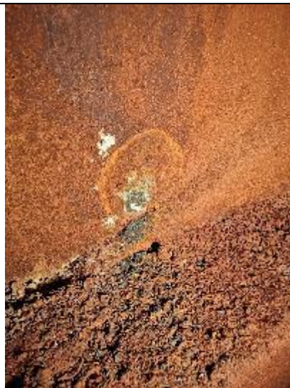
Attēls Nr.8 Izsāļojumi uz rezervuāra sienām
