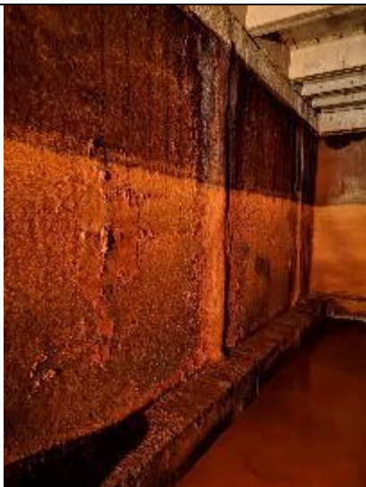
Attēls Nr.7 Izsāļojumi uz rezervuāra sienām
