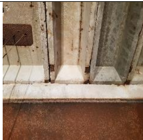
Attēls Nr.12 Nepietiekams betona aizsargslānis, stiegrojuma un ieliekamo detaļu korozija
