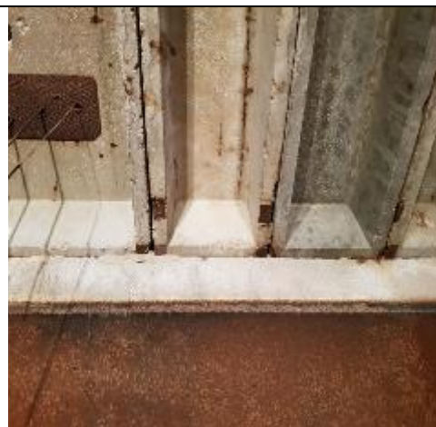
Attēls Nr.12 Nepietiekams betona aizsargslānis, stiegrojuma un ieliekamo detaļu korozija
