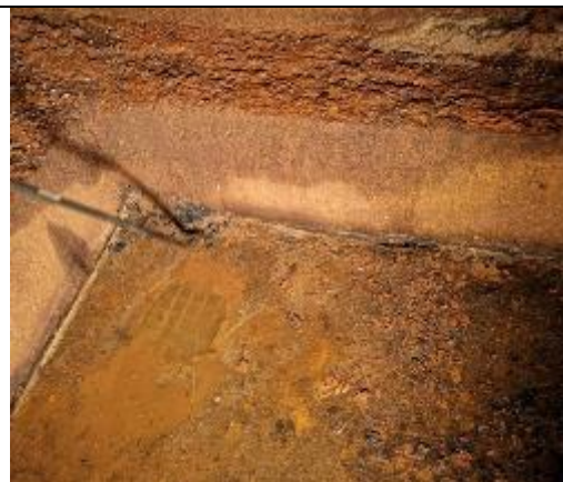
Attēls Nr.2 No veidņiem betonā palikuši koka gabali
