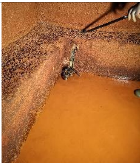
Attēls Nr.3 No veidņiem betonā palikuši koka gabali
